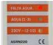
Indicación de falta de agua en el pozo (LED rojo)
